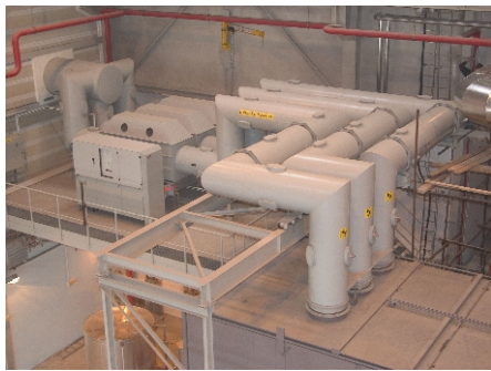
Połączenie generatora z wyłącznikiem Connection between generator and circuit breaker
